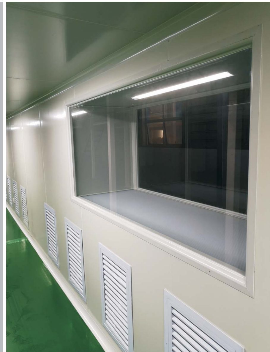
Clean room return air outlet 无尘室回风口
